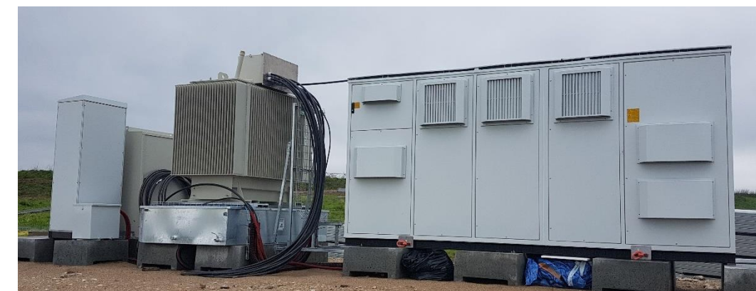
Photographie 66. Exemple d'onduleurs et transformateur installés à l'extérieur
