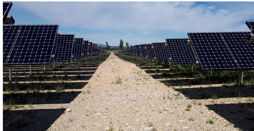
Photographie 70. Exemple d'espace non empierré entre tables
