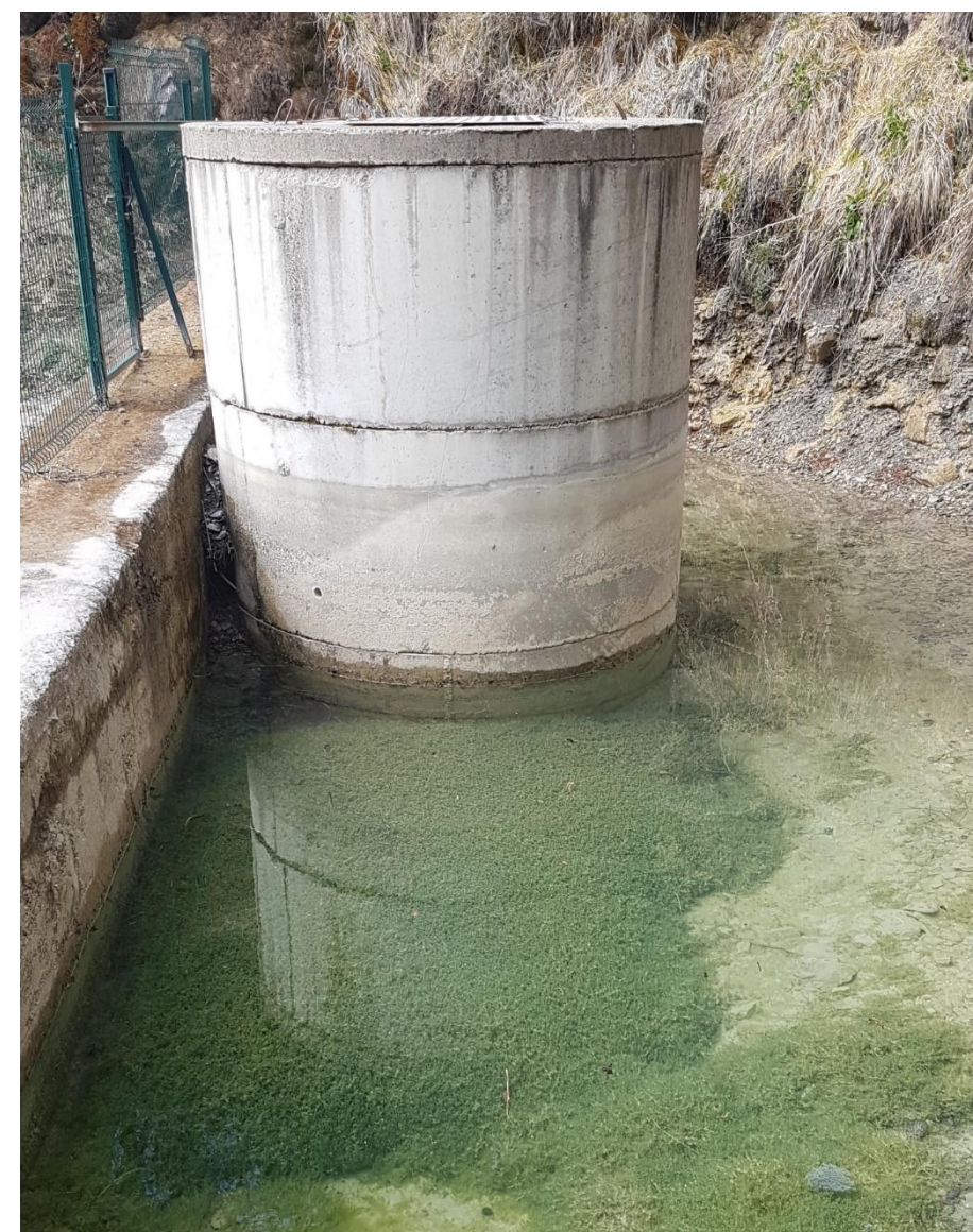
Photographie 16. Captage d'eau superficielle du torrent des Péous
