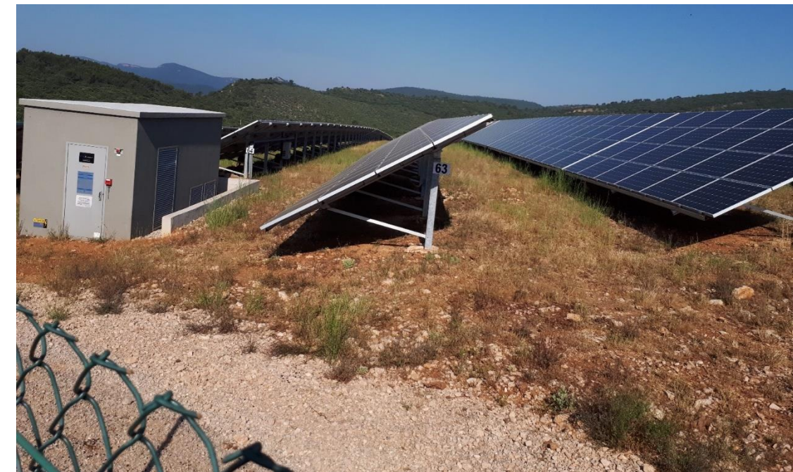
Photographie 85. Piste périphérique et consignes de sécurité à l'entrée du poste de transformation
