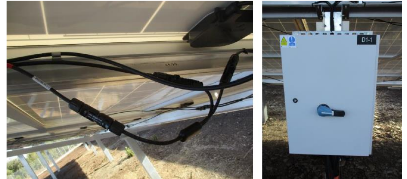
Photographie 68. Exemple de câble électrique et de boîte de raccordement
