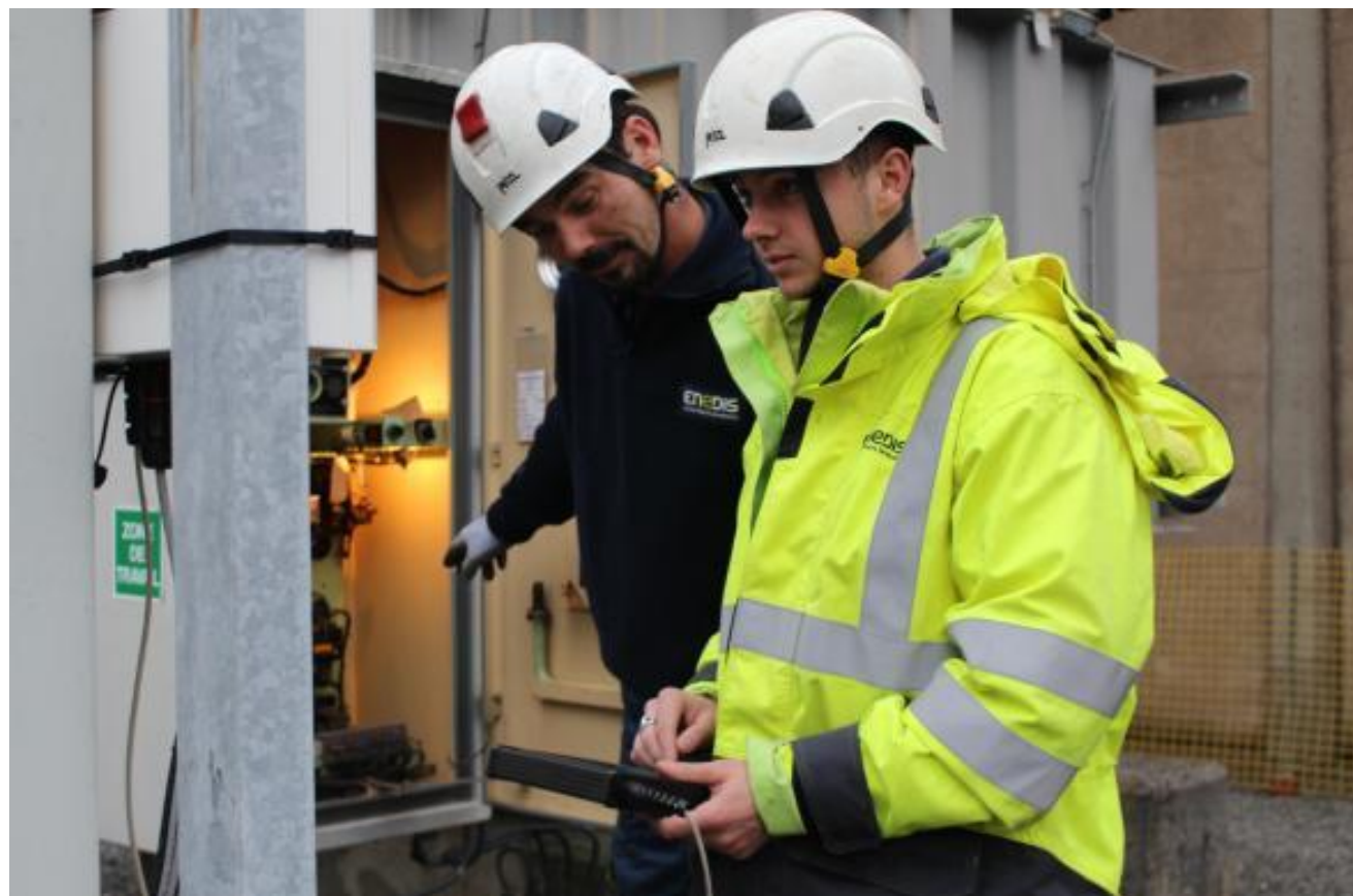
Photographie 76. Mise en service par ENEDIS
